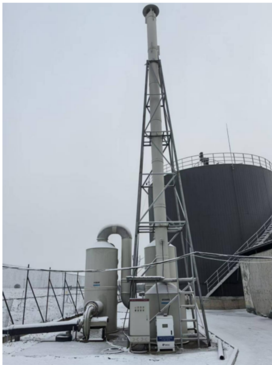
陈腐垃圾好氧稳定化废气治理设施
