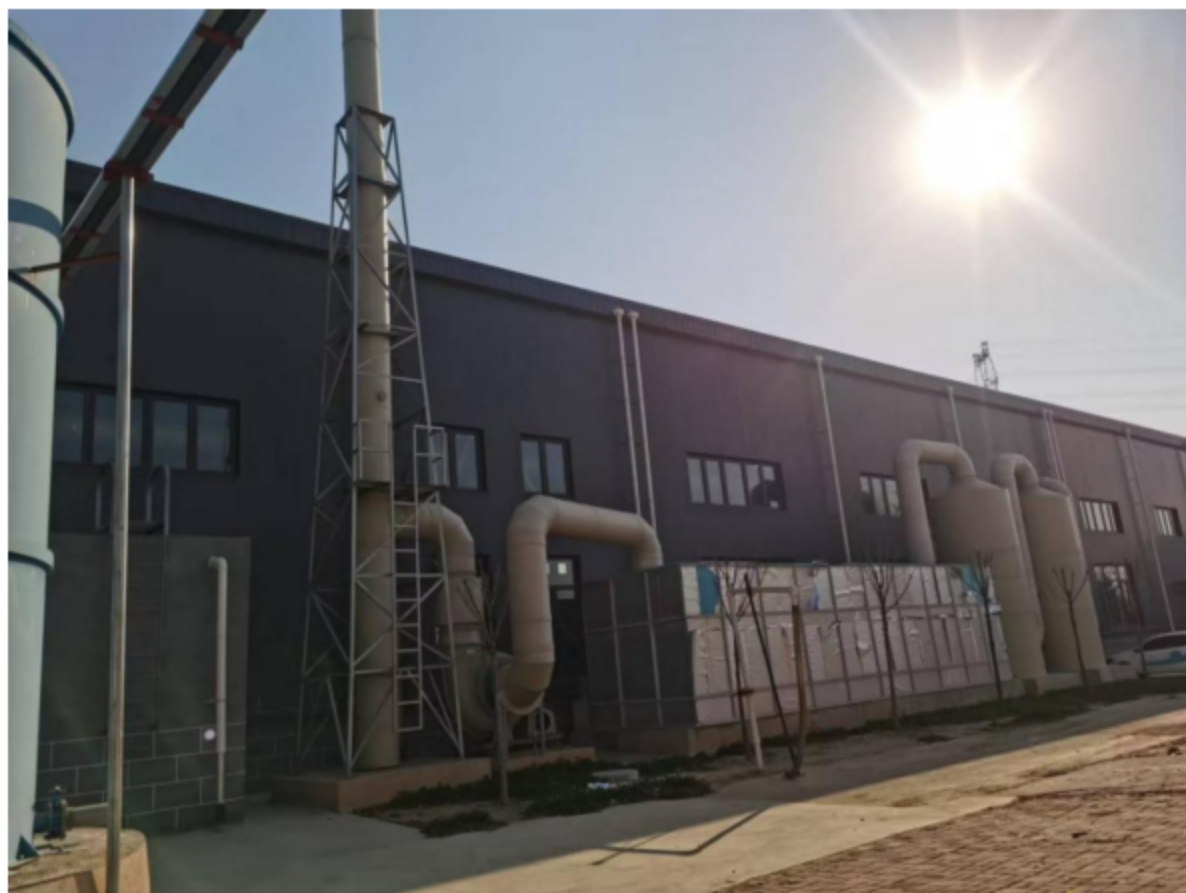
餐厨垃圾处理废气治理设施
