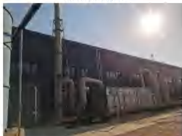
餐厨垃圾处理废气治理设施
