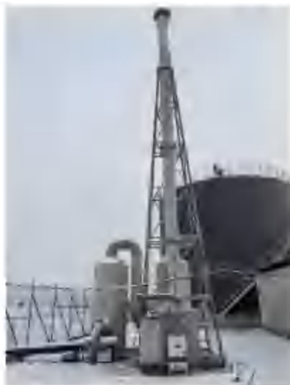
陈腐垃圾好氧稳定化废气治理设施
