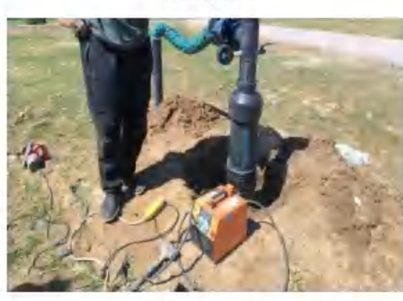
沼气导排管道
